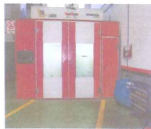
CABINA DE PINTURA Y SECADO AL HORNO
